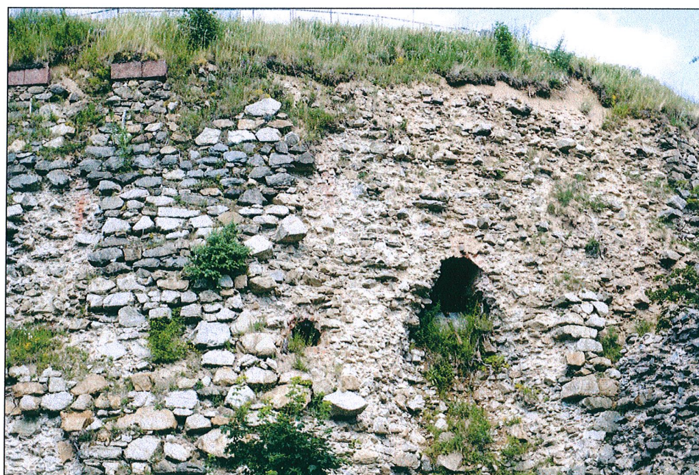
Ściana wieży – strona zachodnia – szczegół uszkodzenia okładziny
