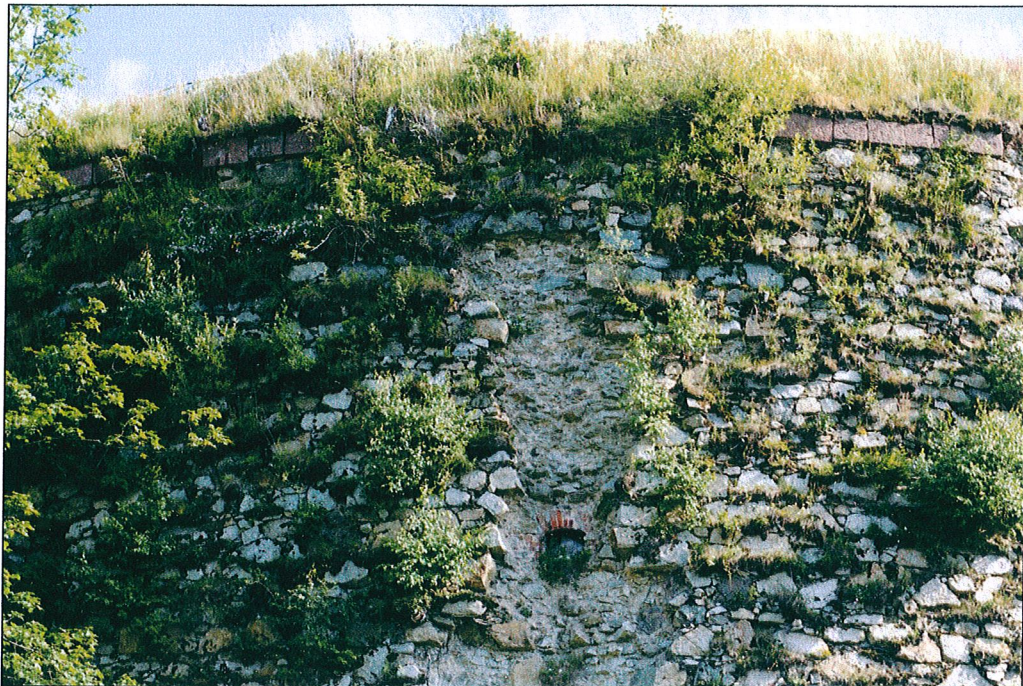
Ubytek okładziny kamiennej na stronie wschodniej wieży - szczegół
