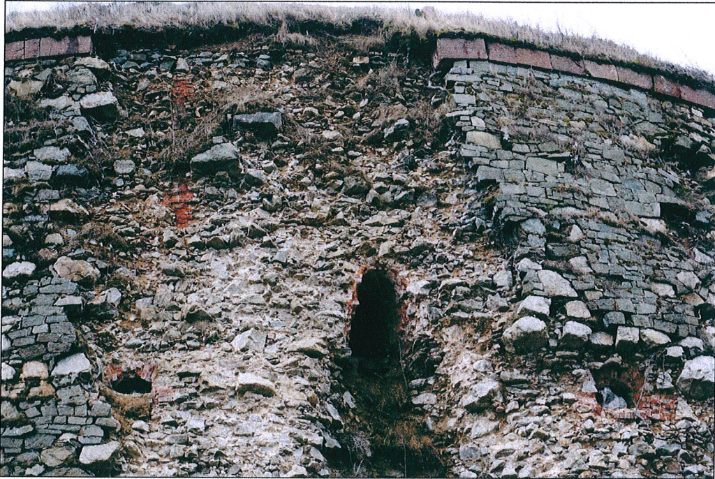
Ubytek okładziny kamiennej na stronie północnej wieży - szczegół
